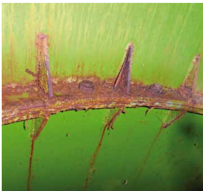
Obr. 5 Výrazná korózia prírubového spoja
