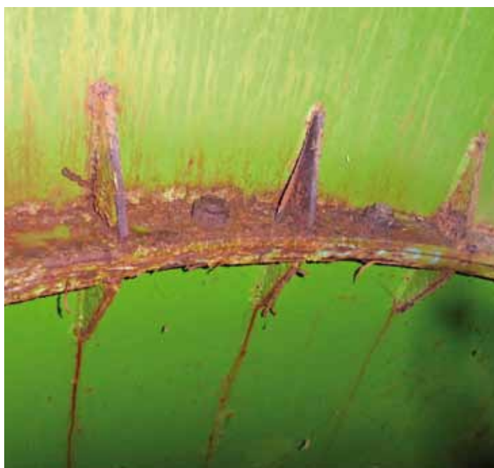
Obr. 5 Výrazná korózia prírubového spoja
