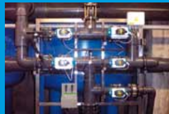
SHP Harmanec - pieskový filter 60m³/hod.
