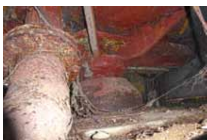
Obr. 5 – Rusovce - klbové uloženie rúry
