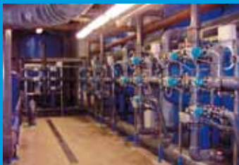
SHP Harmanec - filtračná stanica 360m³/hod.
