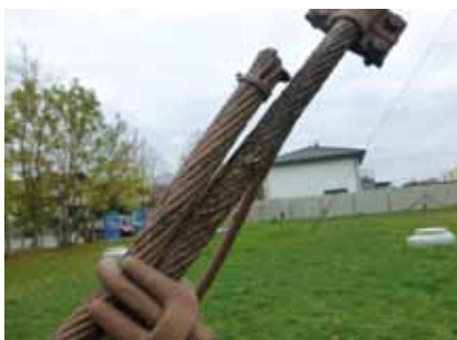
Obr. 8 – Čunovo: Korózia kotevného lana a drieku v mieste nádrže
