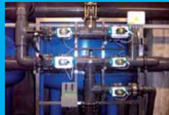
SHP Harmanec - pieskový filter 60m 3 /hod.
