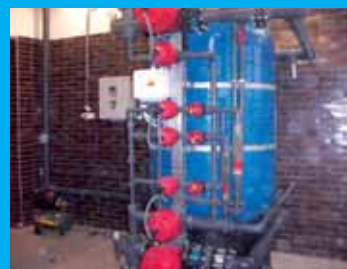
Slovalco - zmäkčovanie chladiacej vody
