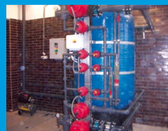
Slovakco - zmäkčovanie chladiacej vody
