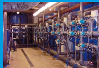
SHP Harmanec - filtračná stanica 360m³/hod.
