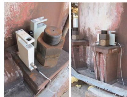
Obr. 6 Snímače naklonenia Libela Steinmayer 2800 v úrovni základov konštrukcie
