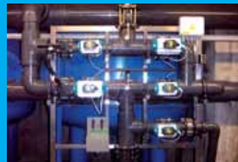
SHP Harmanec - pieskový filter 60m 3 /hod.
