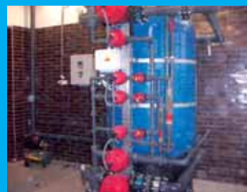
Slovalco - zmäkčovanie chladiacej vody
