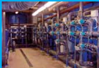
SHP Harmanec - filtračná stanica 360m³/hod.
