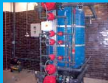
Slovalco - zmäkčovanie chladiacej vody
