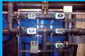
SHP Harmanec - pieskový filter 60m³/hod.
