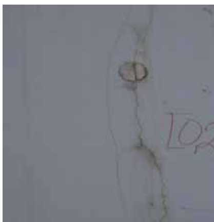
Obr. 2 Praskliny na stenách aktivačnej nádrže
