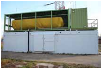
Obr. 6 Bioplynová stanica (BPS), modernizovaná z prostriedkov projektu CE2, so suchou fermentáciou slúži primárne na výskum a pedagogickým účelom (bakalárske, diplomové projekty a pod.).
