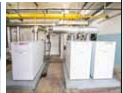
Kotolňa SOŠ RV D. Streda po rekonštrukcii
