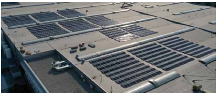
Strešná inštalácia fotovoltickej elektrárne
