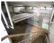
Kotolňa SOŠ RV D. Streda po rekonštrukcii
