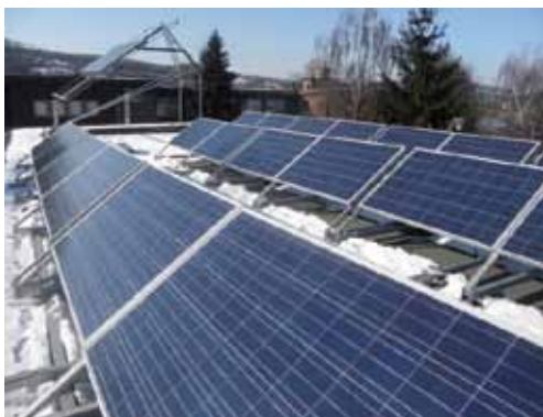
Solárny systém a kotel na drevnú štiepku
