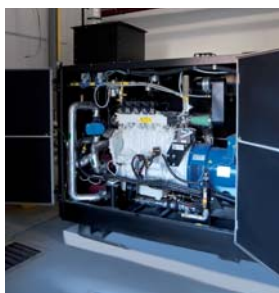
Obr. 1 Kogeneračná jednotka v LVN FEI STU
